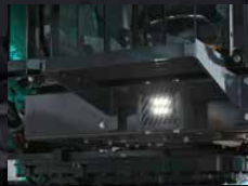
Unter der Kabine (1 Leuchte)
